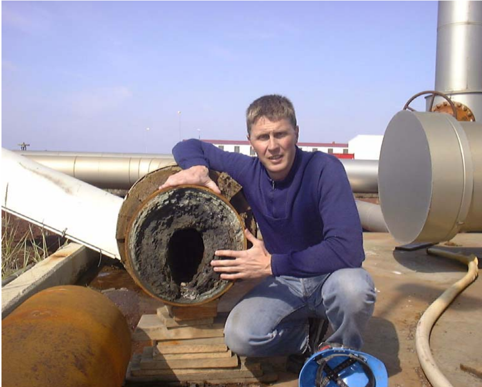
Mynd 17. Útfelling í sjólögn við tank við skiljustöð, rennslisop 22 sm.
