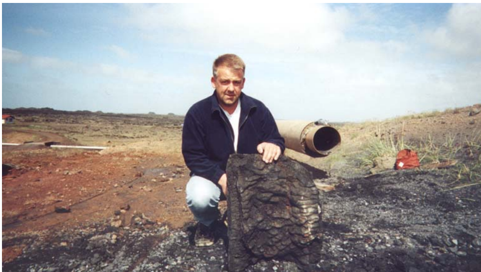
Mynd 14. Útfelling nr. 40 (tafla 11) úr leiðslu frá holu 9 Reykjanesi. Útfellingin er um 15 til 17 sm að þykkt.
