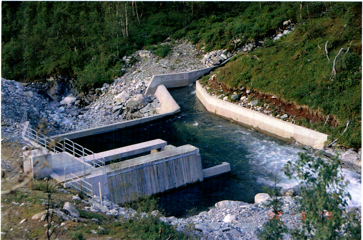
Ljósmynd 3. Lækjarinntak við K4 vatnsorkuverið í Muldal í Tafjord. Þetta inntak var upprunalega af gerð eitt með einföldum stífluvegg, en því varð að breyta vegna ofmettunar á lofti.
