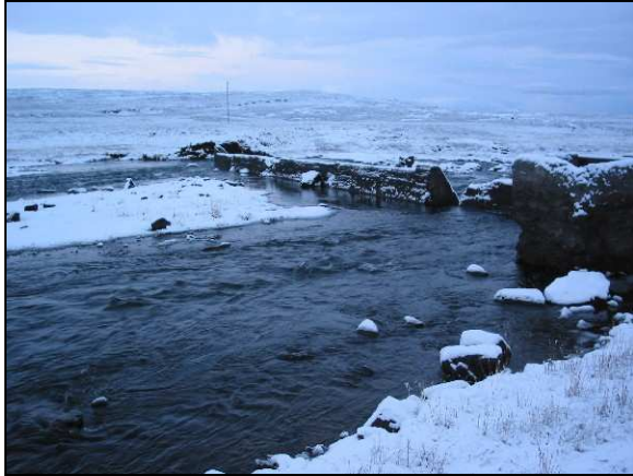
Mynd 8: Gamla stíflan (ónýt)
