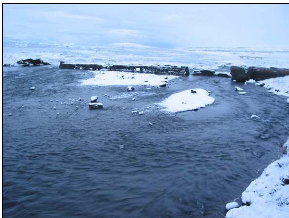
Mynd 11: Gamla stíflan (ónýt)
