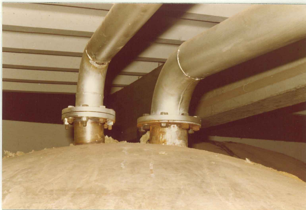
Mynd 3. Rás 1. Leki er á inntaksstút til hægri, undir fláns sem er úr stáli.
