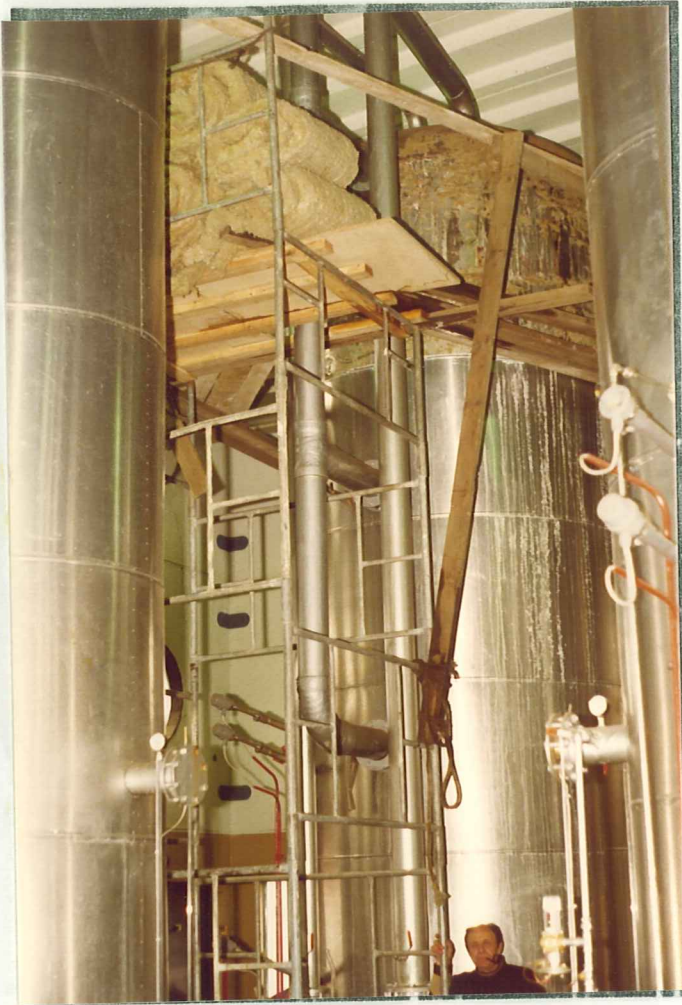
Mynd 1. Afloftari við rás 1. Einangrun fjarlægð efst og sést hrúður eftir vatnsleka.
