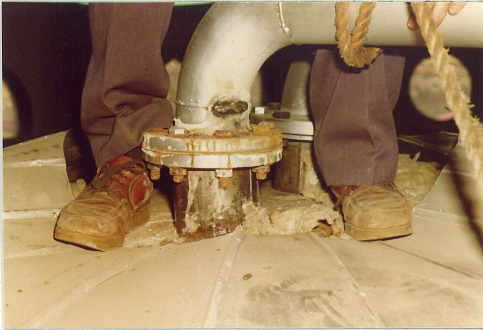
Mynd 7. Inntak á afloftara við rás 2. Leki út frá suðugalla.
