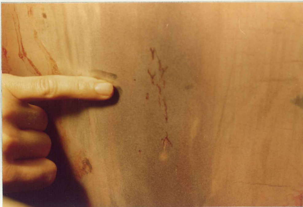
Mynd 5. Belgur á afloftara við rás 1. Bent er á sprungur sem skýrast við notkun sprunguleitarvökva.
